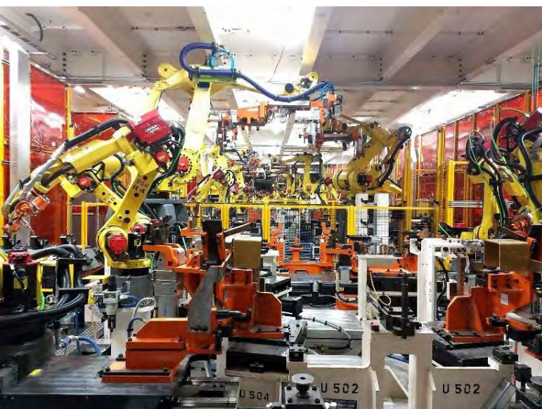
Instalación de Celdas Robóticas
